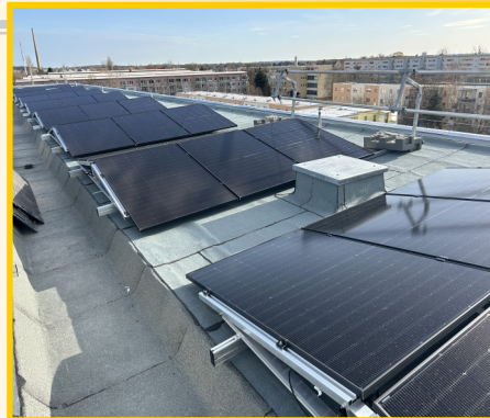
Große PV-Anlage auf dem Dach der Theodor-Körner-Straße 90-100
